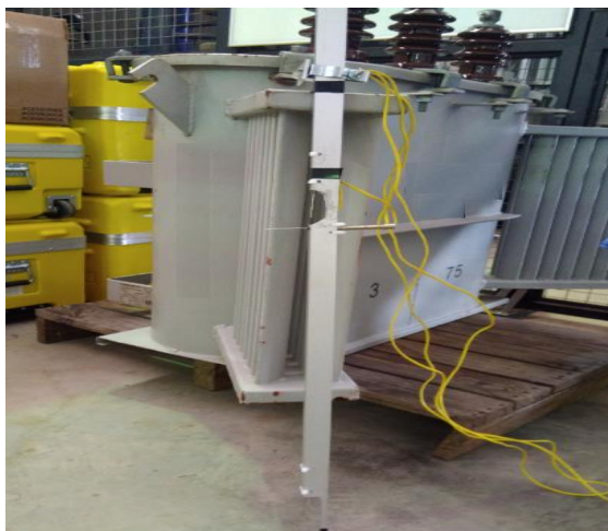
Figura 1- Medidor de temperatura do óleo e Transformador distribuição 75 kVA
